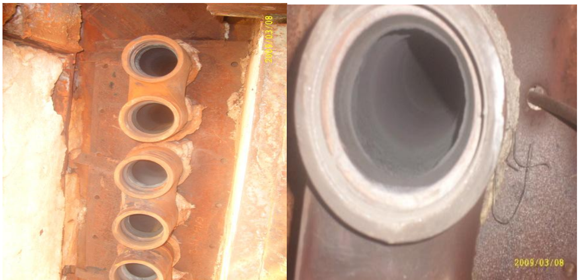
Figura 21. Tubos del horno limpios.
