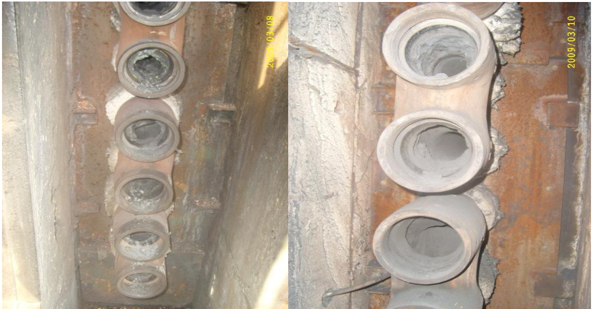
Figura 20. Tubos del horno sucios.
