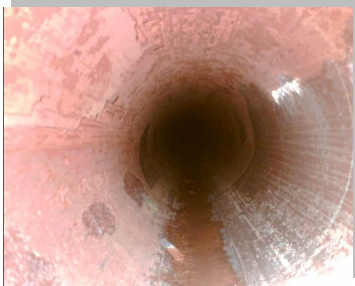
Figura 28. Tubos del horno limpios con Pigging.
