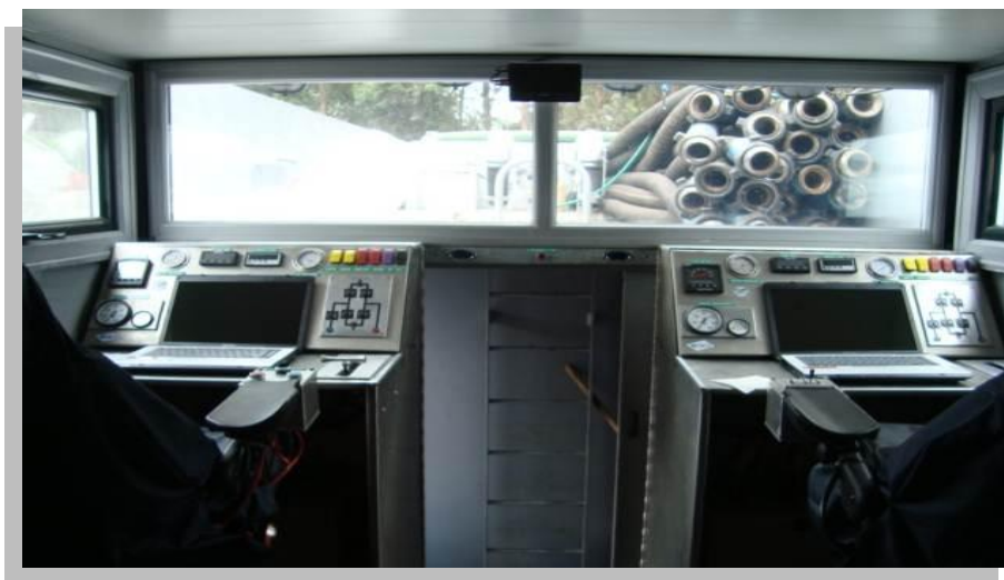
Figura 24. Panel de Control Unidad de Bombeo.
