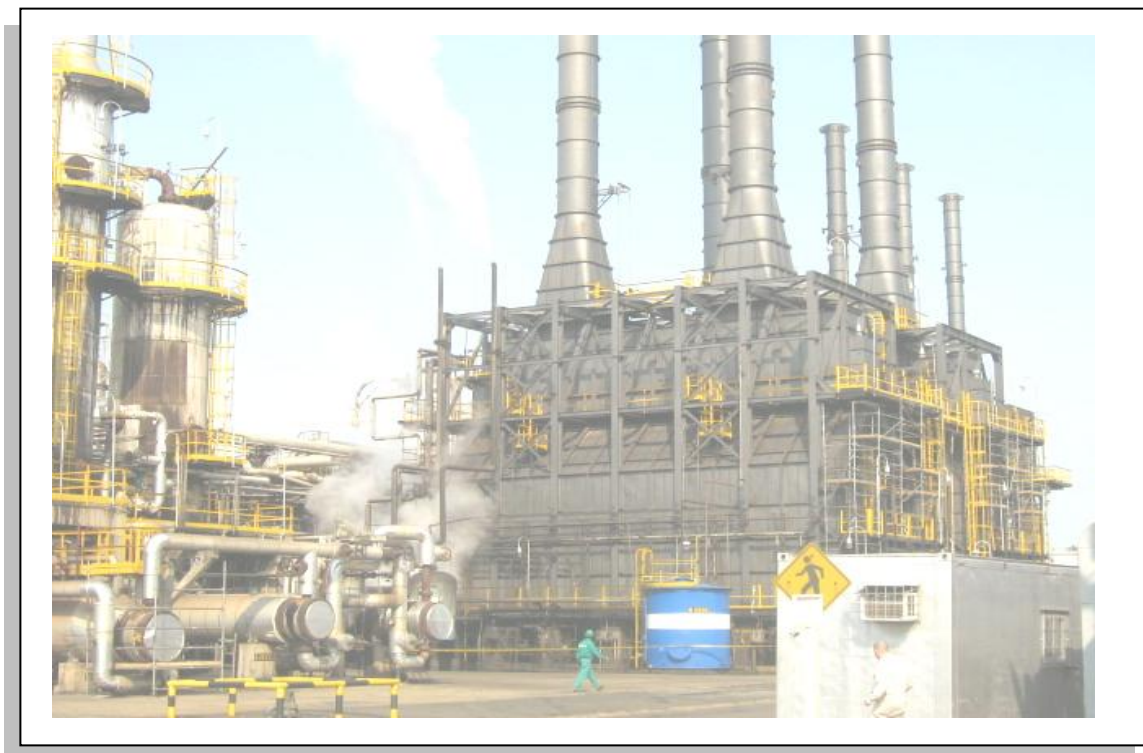
Figura 5. Planta Viscorredutora II.
