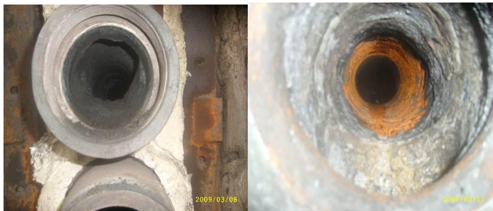
Figura 27. Tubos del horno sucios.
