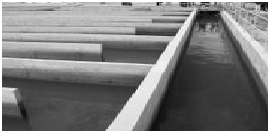
Cámara de Contacto de una Planta de Tratamiento
