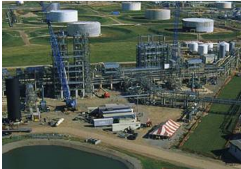
Figura F.14 Planta piloto de GTL en Ponca (Oklahoma)
