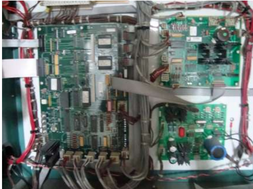
Figura 58. Modulo de control del chiller C.H.
