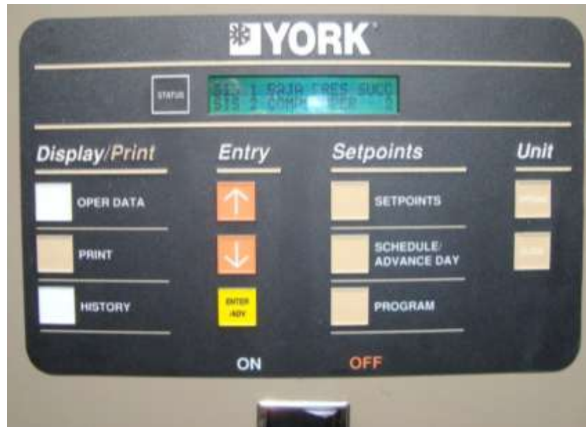
Figura 27. Tablero de control del chiller I.Q.
