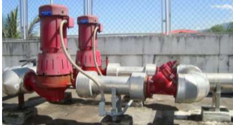
Figura 30. Bombas y válvulas de triple servicio del sistema de agua fría I.Q.
