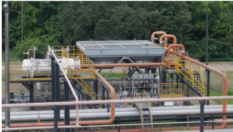
Figura 6. Vista Panorámica planta de enfriamiento de Gas
