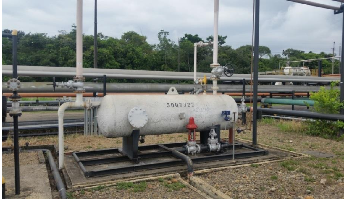
Figura 10. AD1105 Drum de disparo de válvulas de Seguridad
