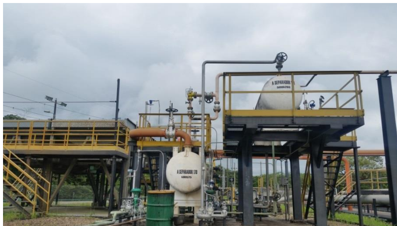
Figura 8. Sistema de Separación de Condensado
