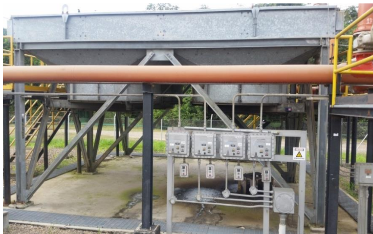
Figura 7. Vista Panorámica Aero enfriadores AE 171 A/B
