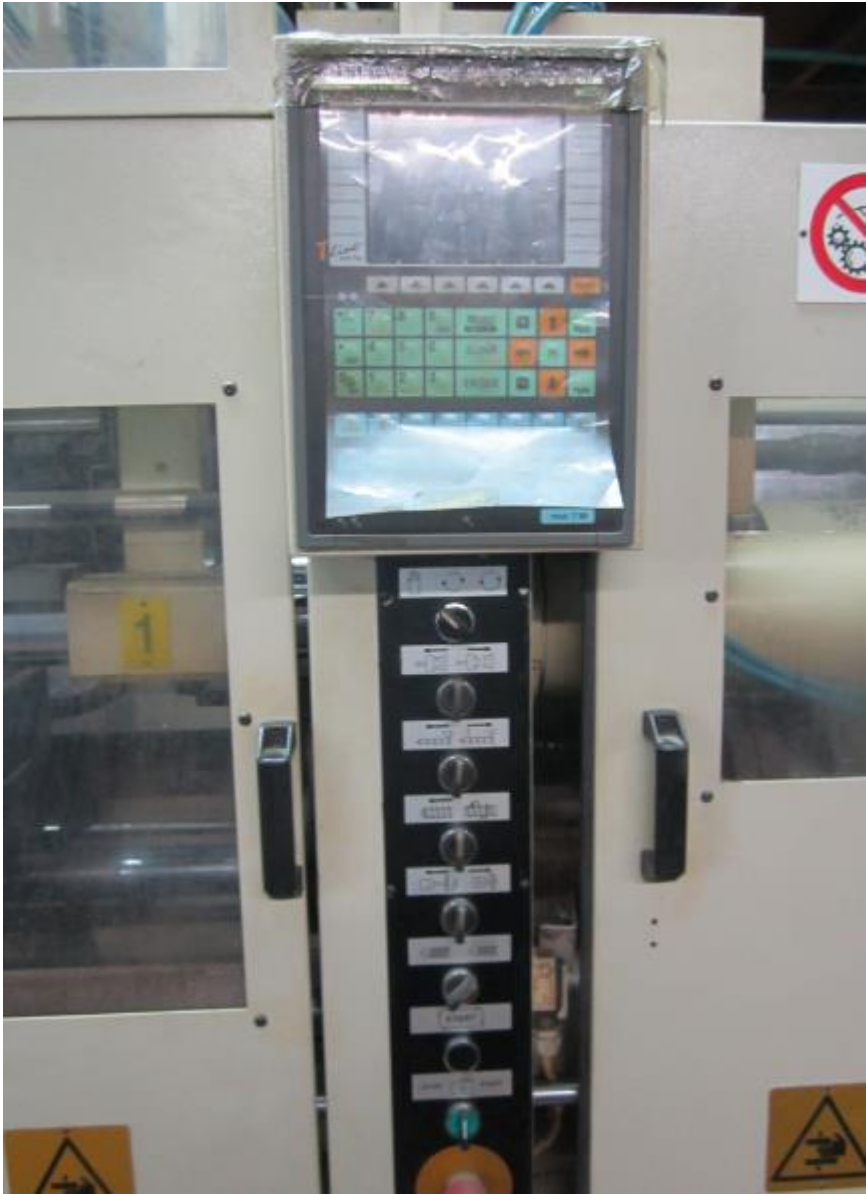
Figura 40. Panel de comando de la maquina
