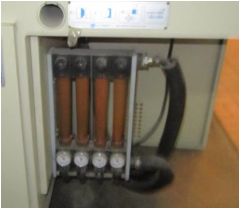
Figura 37. Conexión planta de refrigeración
