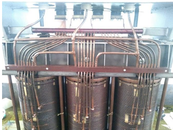
Figura 7. Desencube de transformador de 1000 kVA
