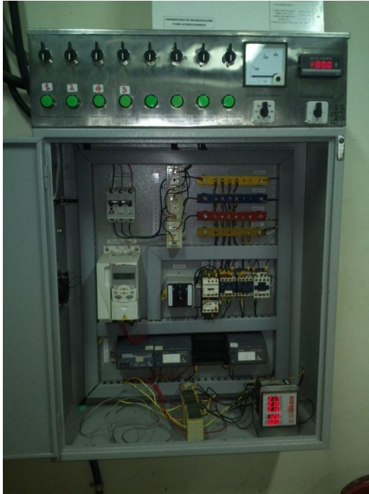
Figura 55. Tablero de control del cuarto frío.
