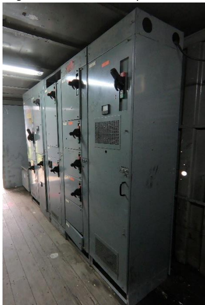
Figura 30. Tablero de potencia.
