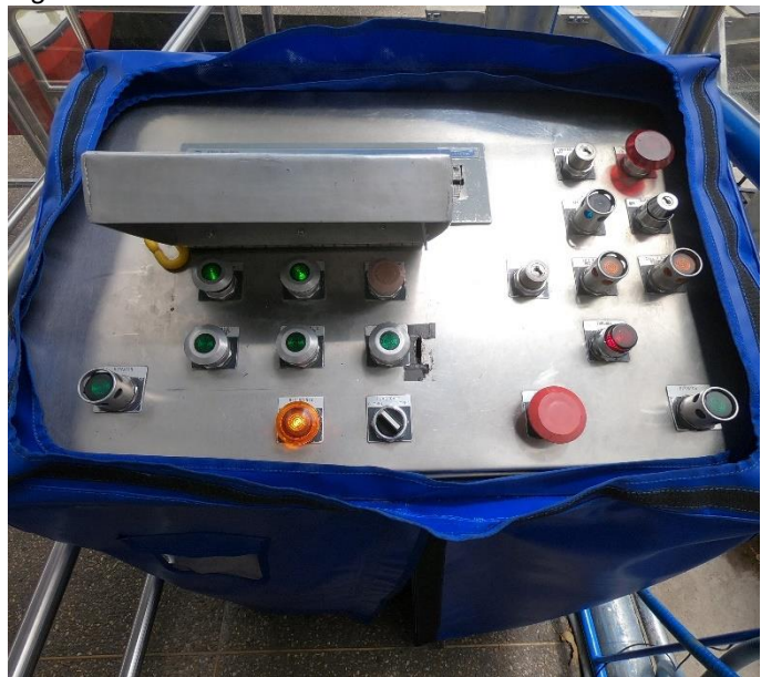
Figura 29. Tablero de control.
