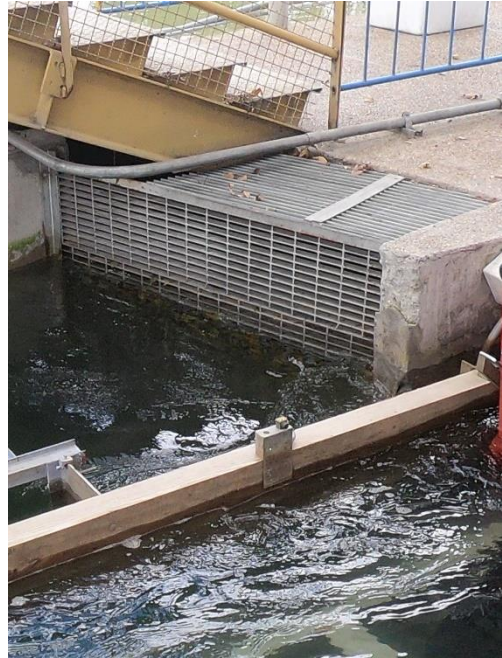
Figura 16. Ingreso agua a turbinas.
