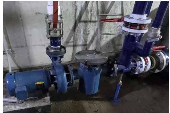
Figura 15. Conjunto bomba de filtrado y trampa.
