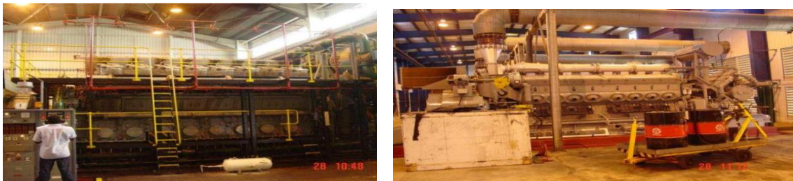
Figura 25. Casa de máquinas unidad A y unidad C, San Andrés Islas
