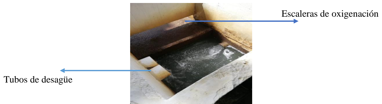
Figura 4. Imagen de la Cámara de aquietamiento PTAP.
