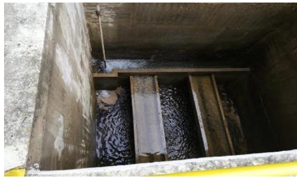
Figura 7. Imagen de los Filtros rápidos de la PTAP
