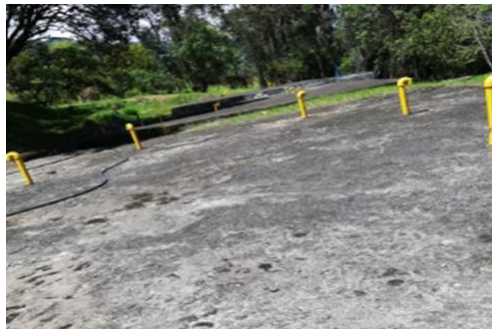
Figura 10. Imagen Tanques de distribución
