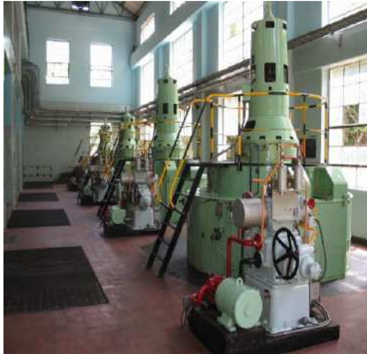
Figura A8. Unidades turbogeneradoras
