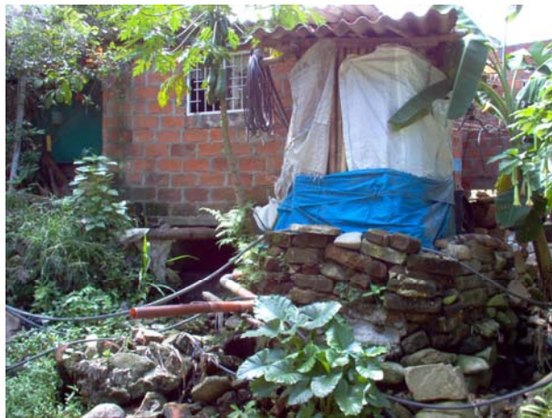
Foto 32. Descarga de un baño a la quebrada
