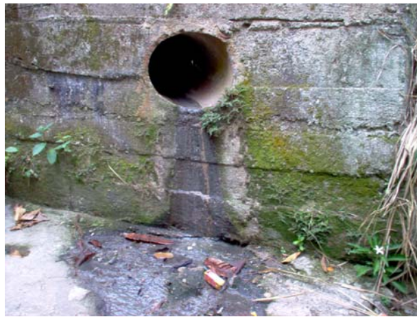
Foto 27. Presencia de detergente en la entrega de las Rondas I y III
