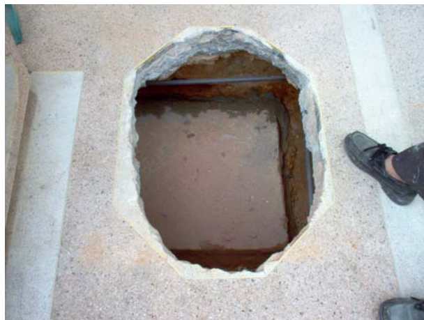
Foto 18. Arreglo de cajas domiciliarias invertidas
