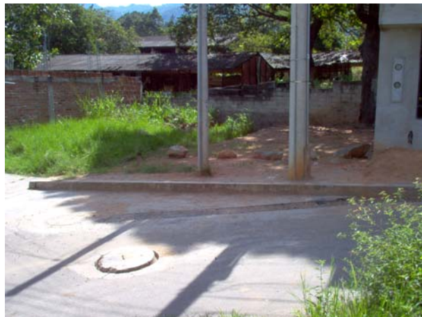
Foto 14. Conexión directa al pozo de aguas negras
