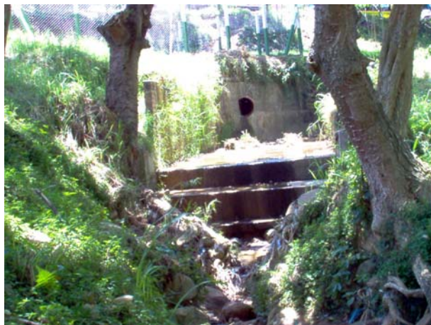
Foto 5. Zona donde termina la canalización y vertimiento contaminante
