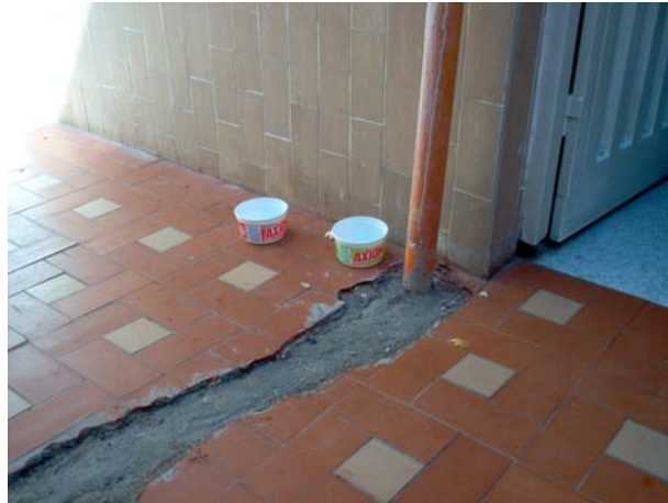
Foto 17. Conexión al bajante de aguas lluvias
