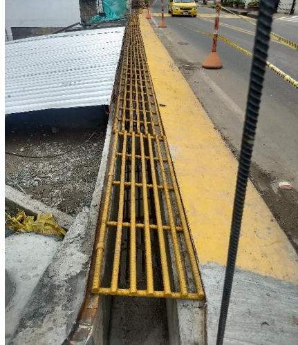
Figura 5. Canal rectangular para recolección de aguas lluvias provenientes de la vía principal.
