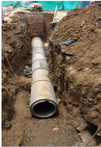
Figura 4. Pozo de inspección y colector para transporte de aguas negras.
