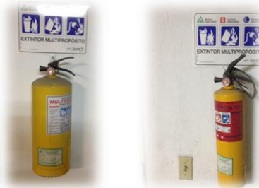
Figura 21. Extintores reubicados y señalados
