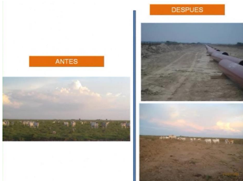
Figura 34: Afectaciones Construcción del ODL
