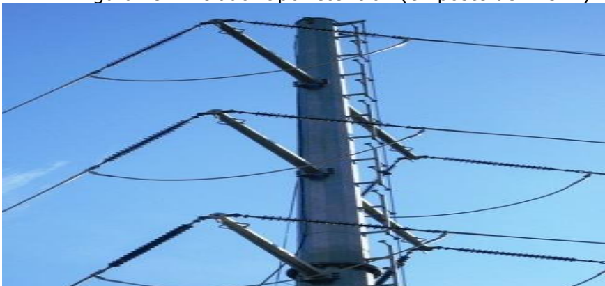
Figura 19. Aislador tipo retención (en poste de 115kV)
