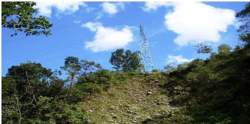
Figura 34. Falla geológica al lado de una torre
