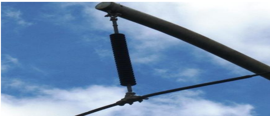
Figura 18 Aislador tipo suspensión (en poste de 115kV)
