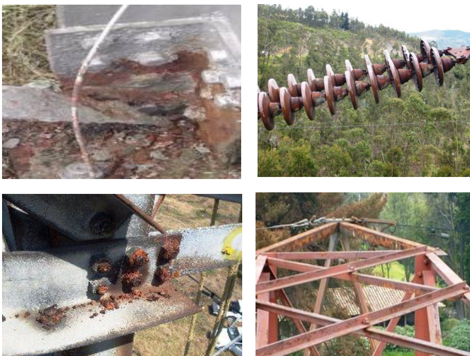
Figura 36. Afectación por corrosión ambiental
