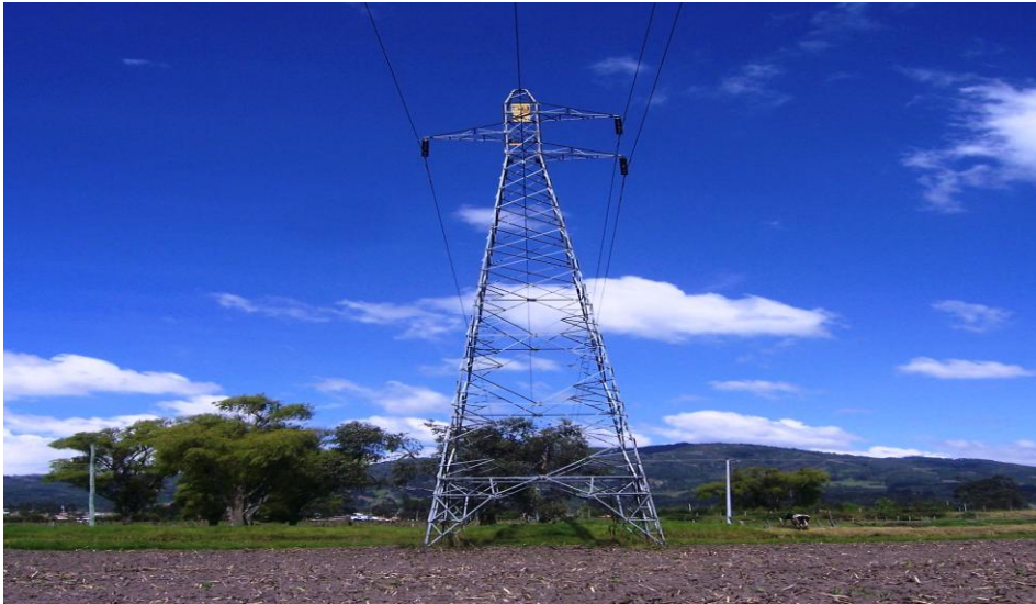
Figura 24. Torre (celosía) para línea de 115 kV de un circuito
