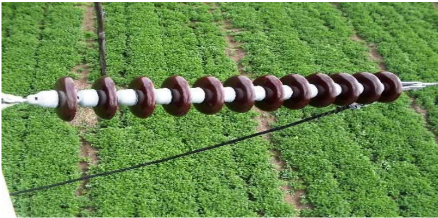
Figura 15. Cadena de aisladores en porcelana para 115 kV (retención)
