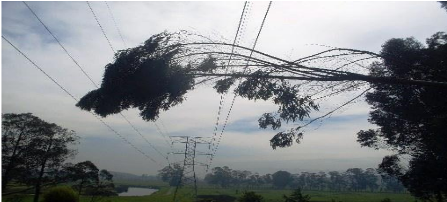
Figura 35. Árbol sobre conductores
