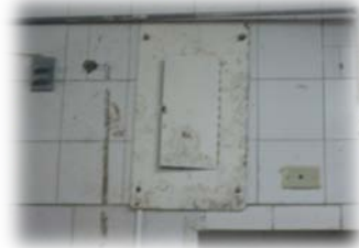
Figura 22. Cajas de tacos oxidadas.
