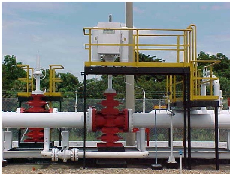
Figura 9. Foto de una Válvula de Seccionamiento.
