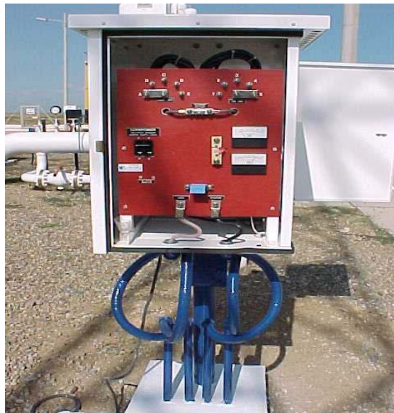
Figura 12. Rectificador estación Ballena.
