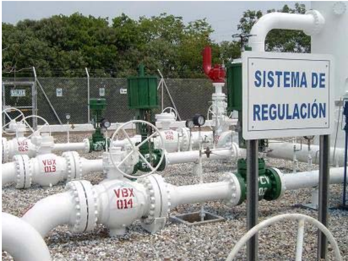
Figura 6. Sistema de Regulación de la estación Barrancabermeja
