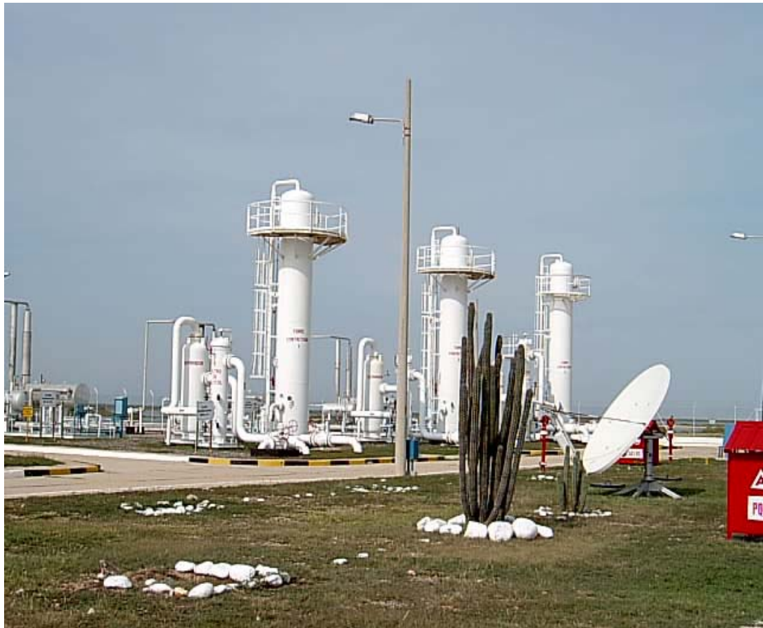
Figura 2. Planta deshidratadora de gas de la estación Ballena.
