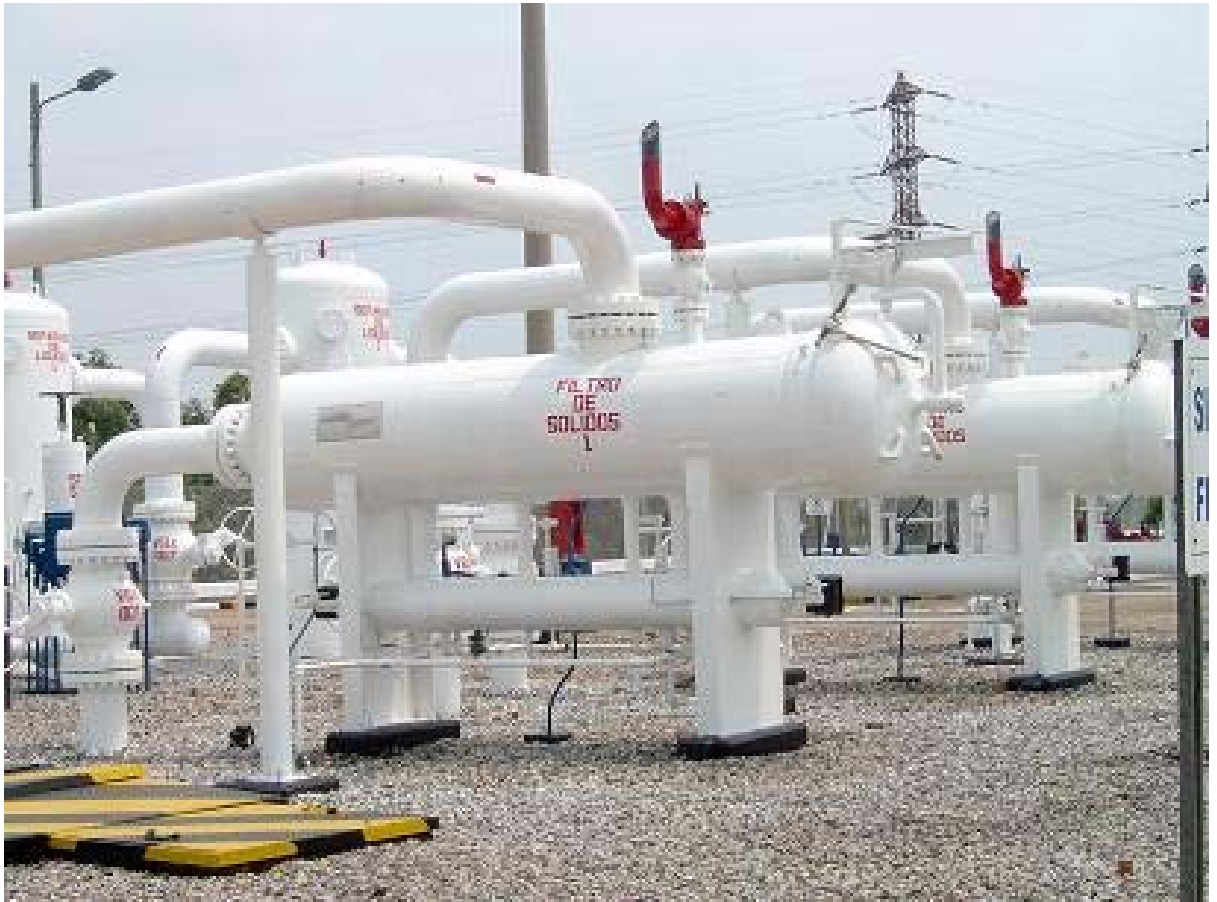
Figura 5. Sistema de Filtración de la estación Barrancabermeja.
