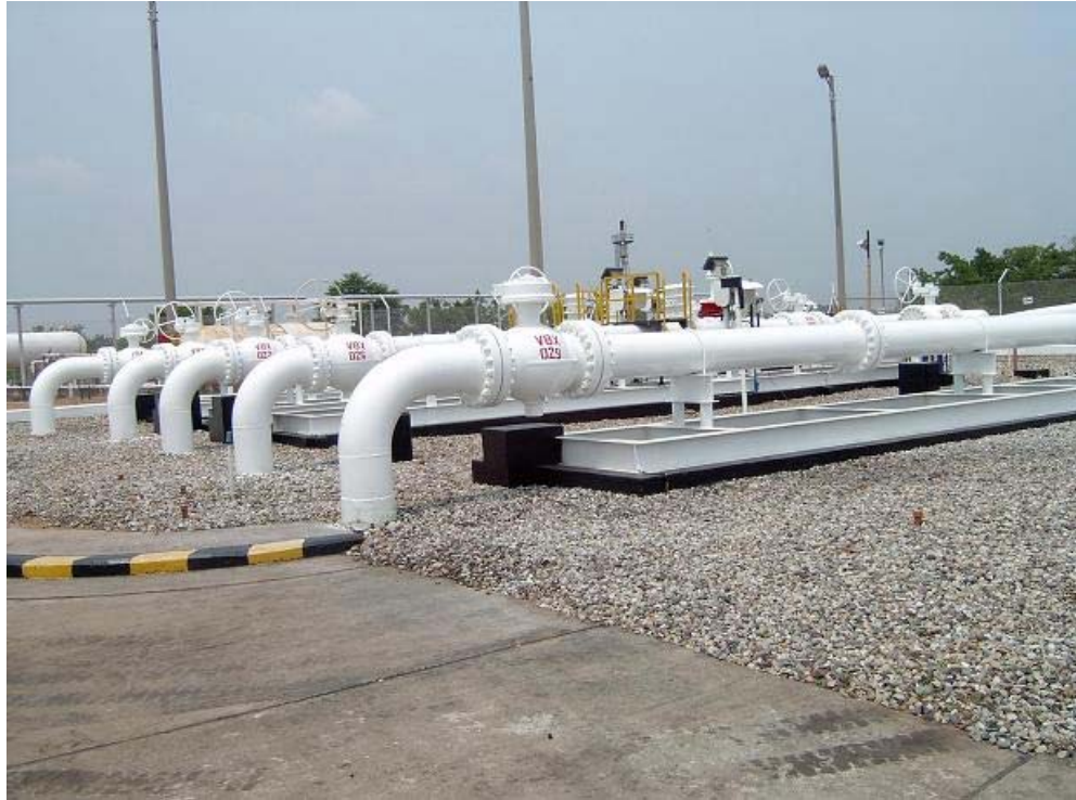
Figura 8. Sistema de Medición de la estación Barrancabermeja.
