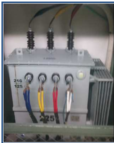
FIGURA 17. Transformador de potencia de 225 kVA.
