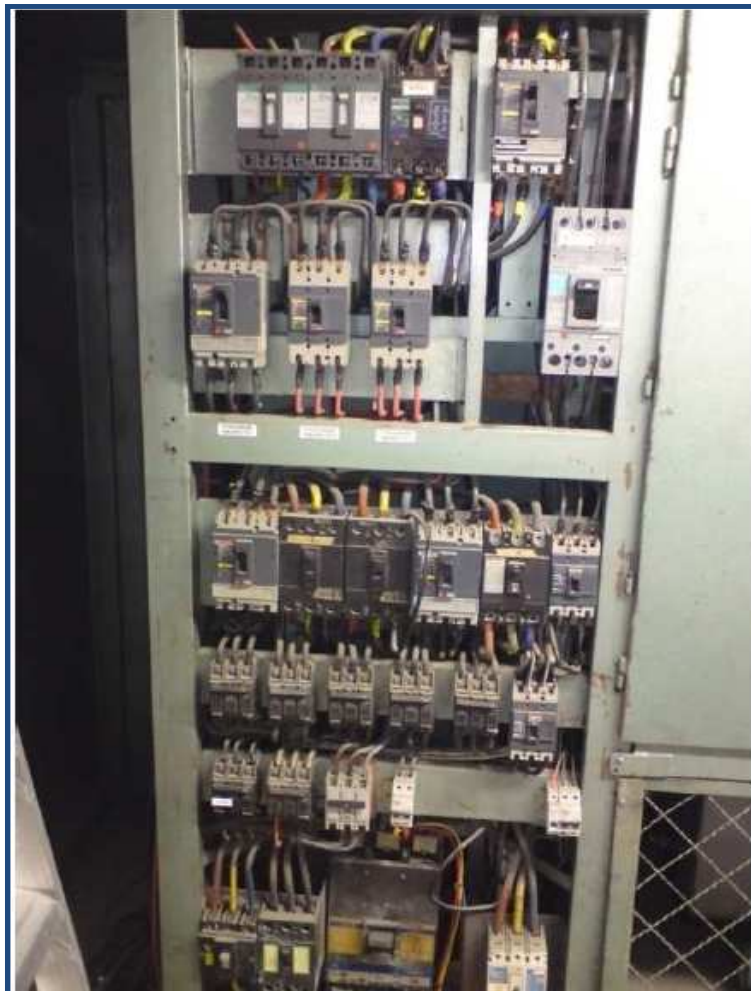
FIGURA 18. Tablero General de Baja Tensión TGB-2.
