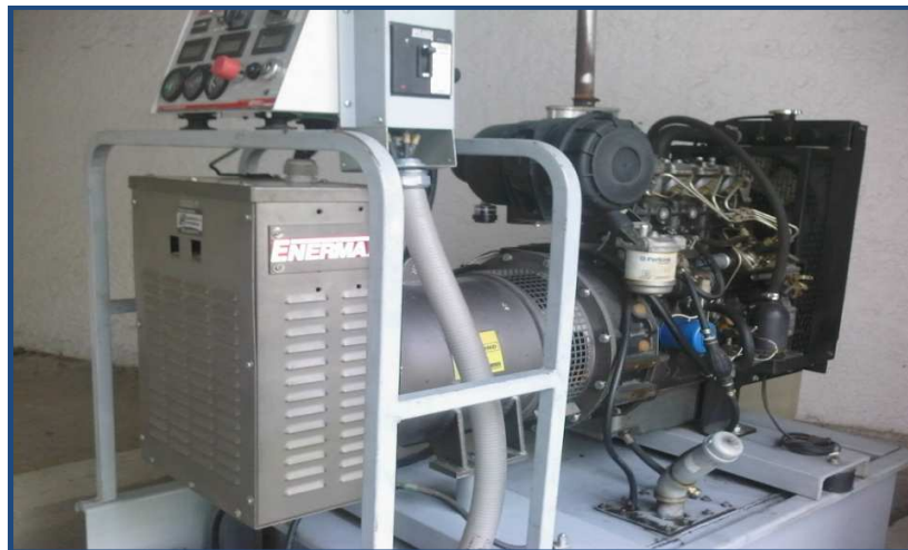
FIGURA 43. Planta de emergencia.
