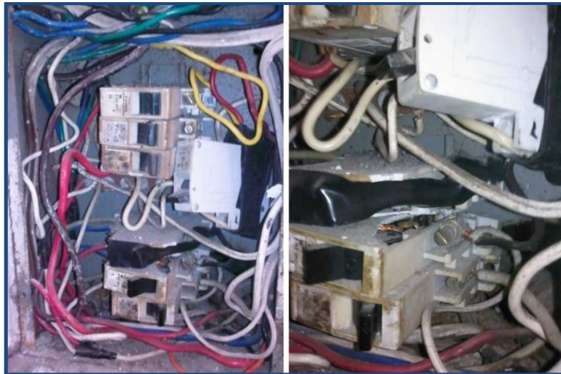
FIGURA 41. Daño de interruptores Automáticos.
