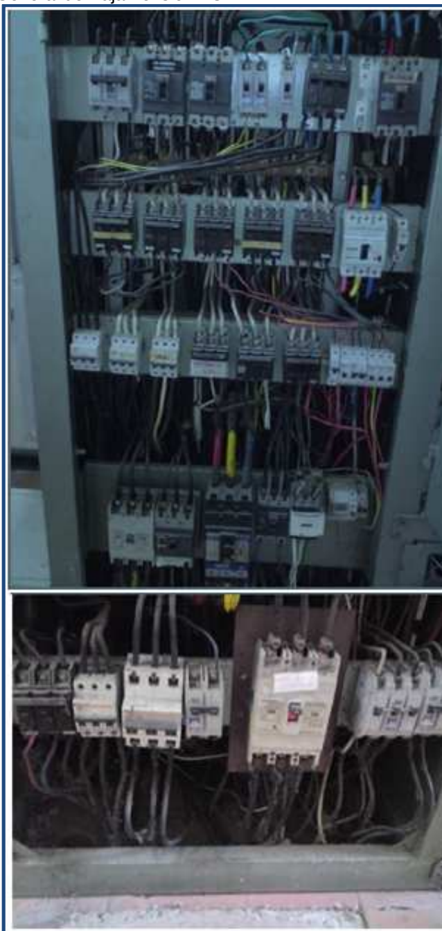
FIGURA 14. Tablero General de Baja Tensión TGB-1.
