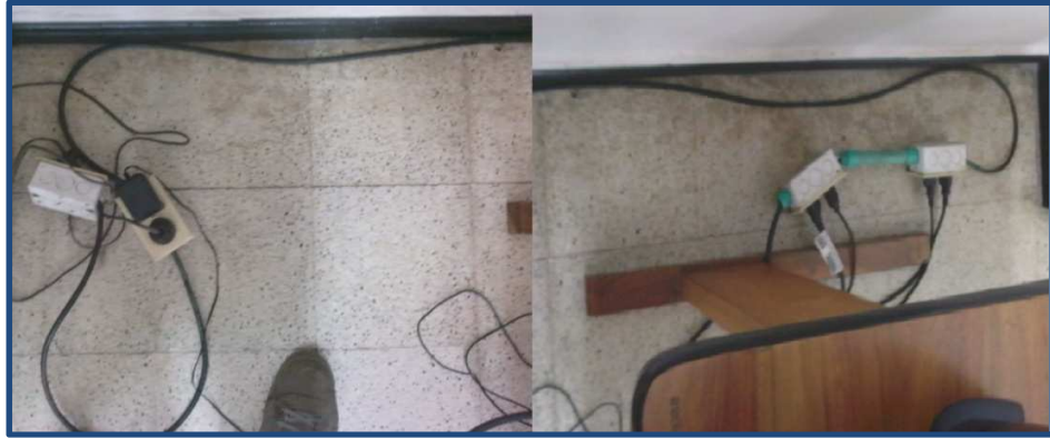
FIGURA 42. Extensiones eléctricas Sala de Profesores.
