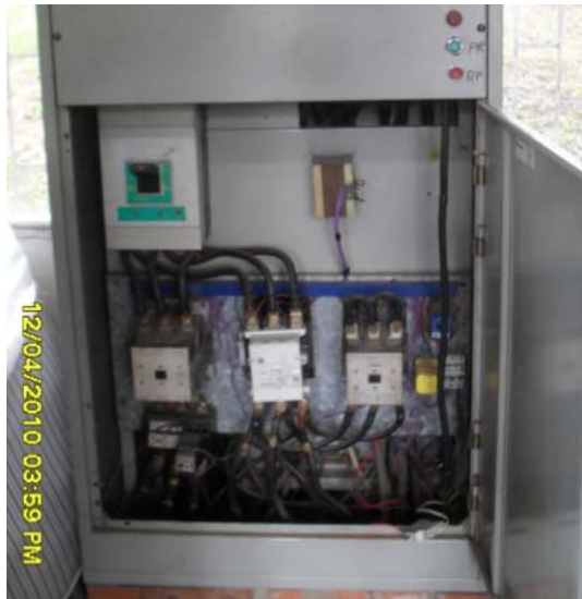
Figura 25. Tablero eléctrico sistema de bombeo N° 3
