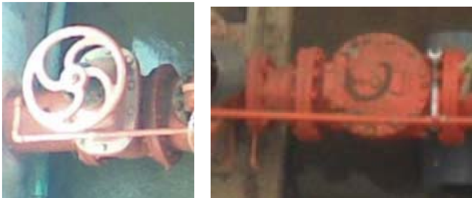
Figura 32. Válvulas línea de impulsión antes del cabezal
