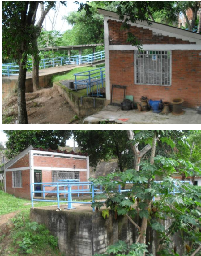
Figura 4. Tanques predesarenadores y de succión de los sistemas de bombeo N° 1 y 2
