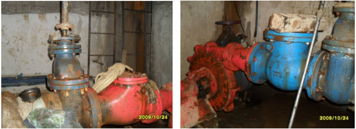
Figura 29. Válvula y cheque de descarga
