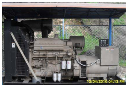
Figura 21. Generador eléctrico Diesel
