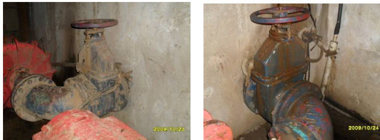
Figura 28. Válvulas de succión
