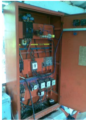
Figura 23. Tablero eléctrico sistema de bombeo N° 1 y 2
