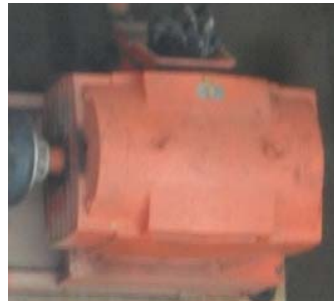
Figura 17. Motor eléctrico sistema de bombeo N° 3
