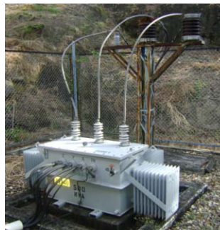
Figura 20. Transformador de 500 KVA
