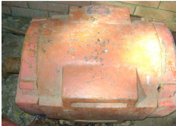
Figura 15. Motor eléctrico sistema de bombeo N° 2
