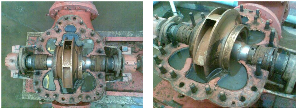
Figura 16. Vista general de la bomba al retirar la tapa
