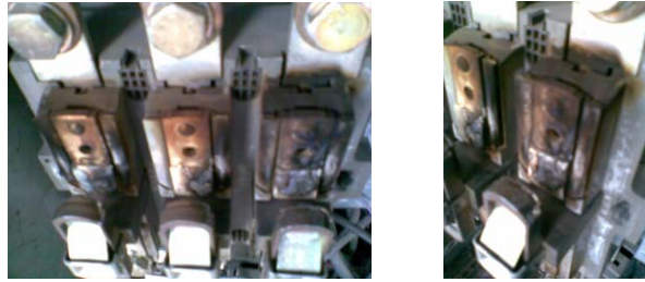
Figura 26. Contactores sistemas de bombeo N° 3
