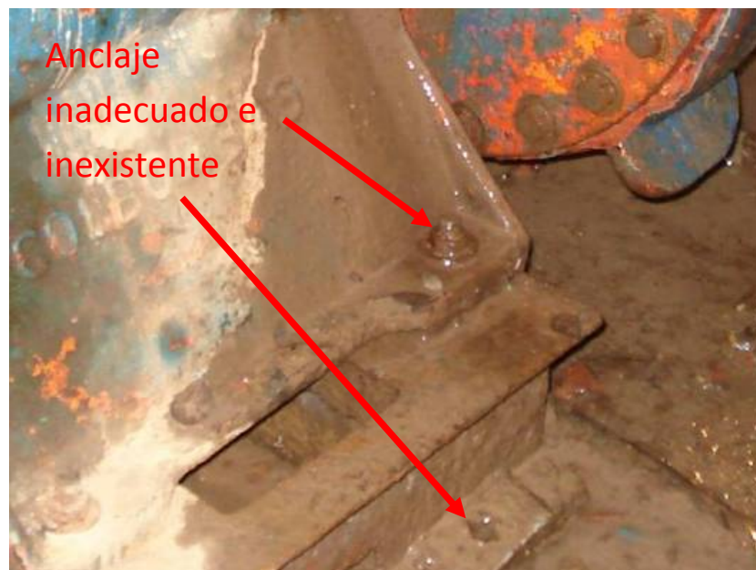
Figura 8. Anclajes Sistema de bombeo N° 2
