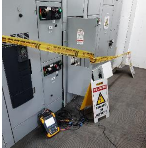
Figura 6. Instalación Fluke 435 en el MCC Econopac.
