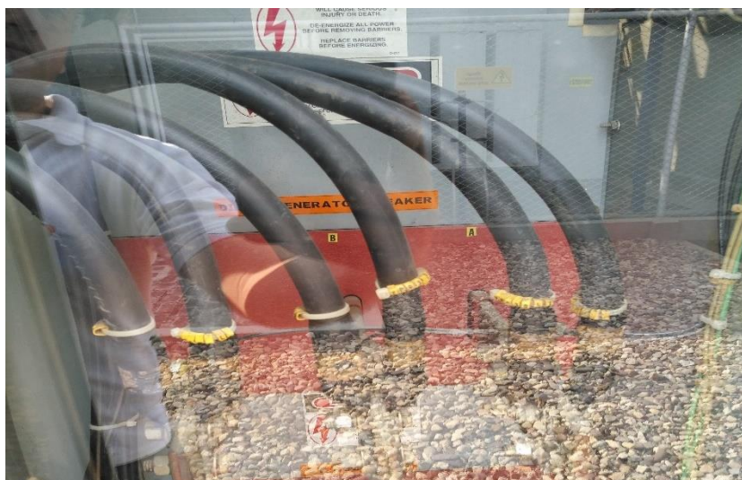
Figura 14. Incumplimiento en el SwitchGear con el ítem 2.
