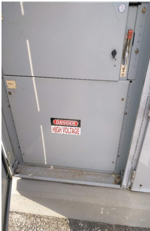
Figura 15. Incumplimiento en el SwitchGear con los ítems 4 y 5.
