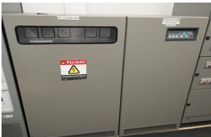
Figura 18. Incumplimiento de la UPS y banco baterías en los ítems 2 y 6.
