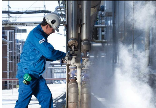
Figura 2. Trabajador Revisando Válvula
