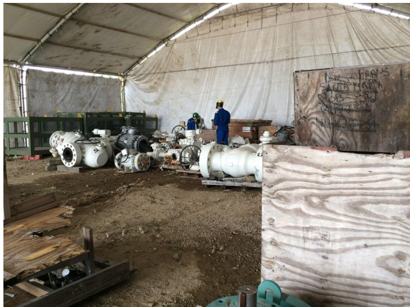
Figura 28. Carpa para disposición de válvulas repuestos
