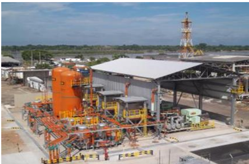
Figura 17. Planta de compresión de aire ubicada en central del norte - GRB. Adaptada de: Archivo PMSI 2013 - GRB
