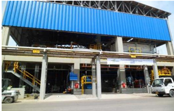
Figura 15. Planta de agua UF/RO instalada en GRB. Adaptado de: Archivo PMSI 2013 – GRB
