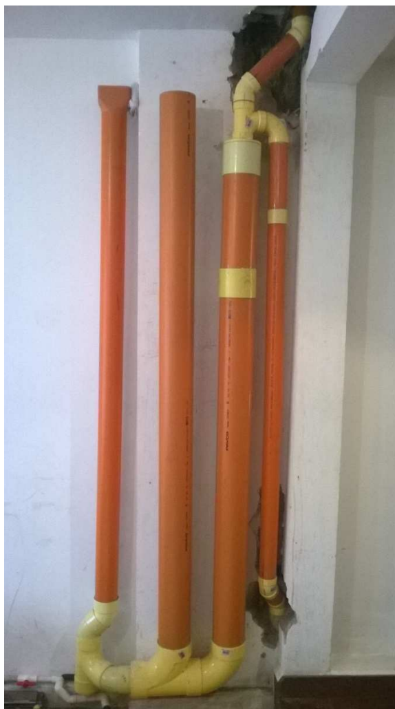
Fotografía No. 4 Interceptor de primeras lluvias de la parte anterior de la cubierta.
