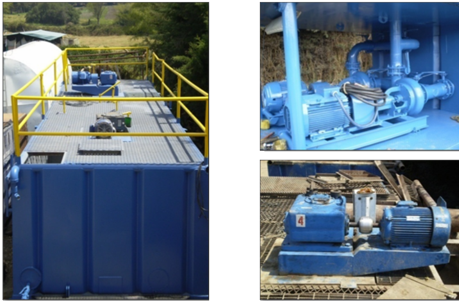
Figura 16 Tanque de lodos, bombas centrifugas y agitador.
