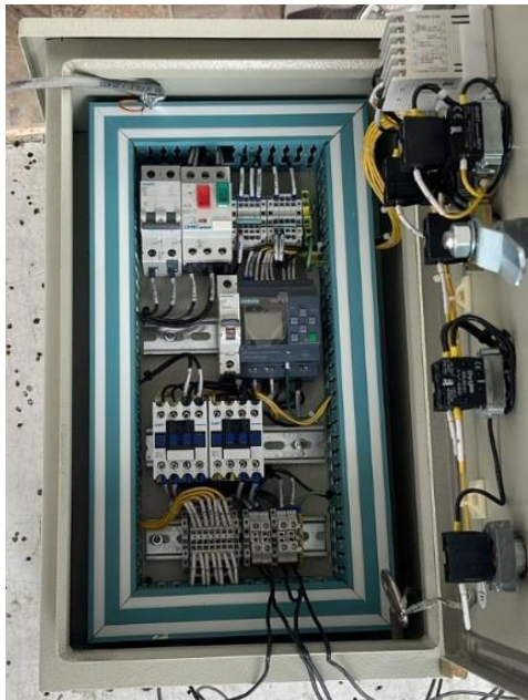
Figura 51. Conexiones eléctricas de la caja de control.
