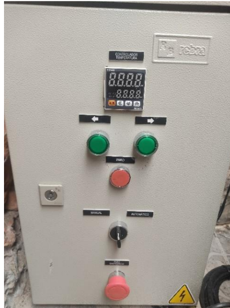
Figura 50. Posicionamiento pulsadores y componentes del tablero de control.
