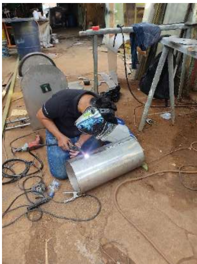
Figura M.8. Soldadura en la cámara de tostado.
