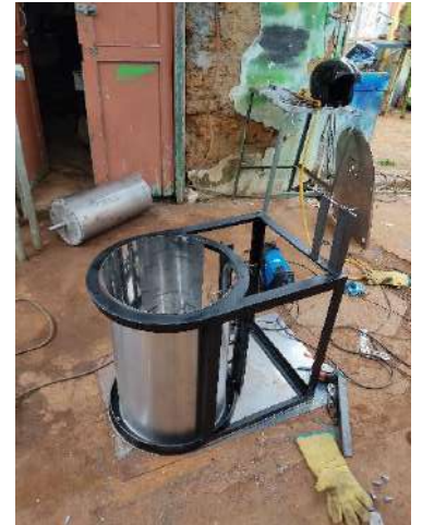
Figura M.14. Aplicación de soldadura en la lámina para fijación a la estructura.
