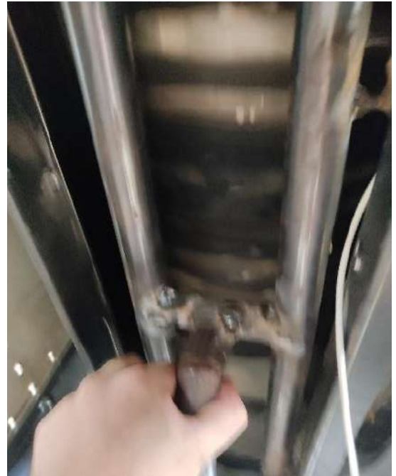
Figura M.19. Fijación del quemador a la estructura metálica de la máquina.
