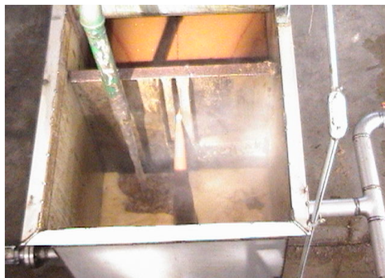
Figura 18. Vertedero del tanque de dilución.
