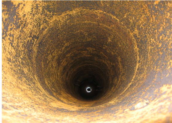
Figura 41. Estado interno de la Despojadora D3. 55
