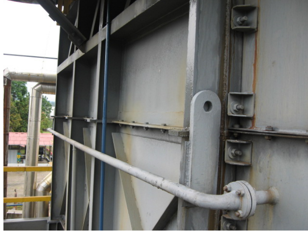
Figura 27. Vista externa de la carcasa del horno F1. 41
