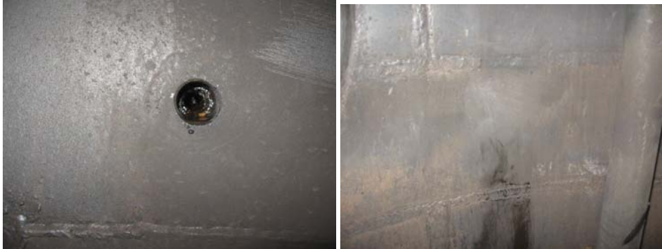
Figura 33(a) y (b) Estado del lining en el domo inferior de la Torre de destilación Atmosférica 47
