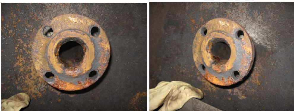
Figura 31 (a) y (b) Brida interna del tubo de reciclo. Torre de destilación Atmosférica 45
