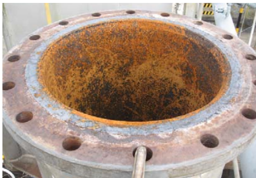
Figura 40. Estado de la brida en la despojadora D3. 54
