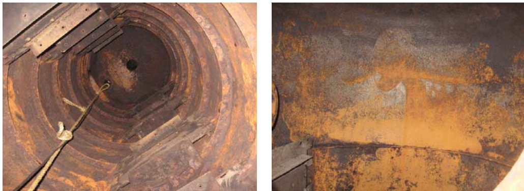
Figura 30. (a) y (b) Domo Superior de la Torre de destilación Atmosférica 44
