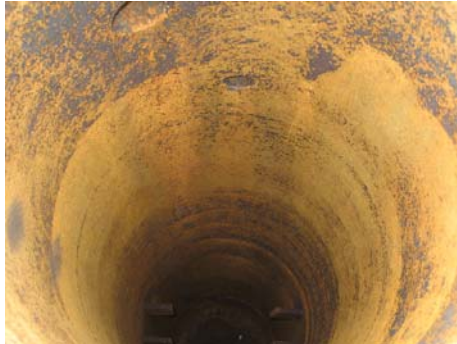
Figura 38. Estado interno de la Despojadora D2. 52
