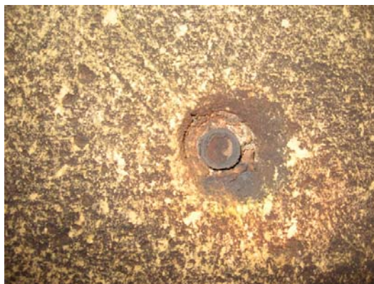
Figura 21. Termopozo en pared de zona de radiación. 35
