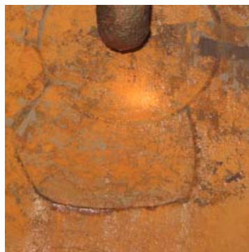
Figura 50. Estado del Parche soldado en Cap occidental
