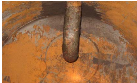
Figura 49 Estado del tubo de entrada. 62
