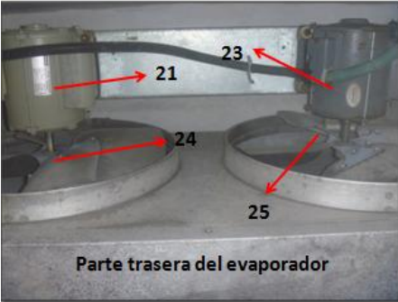
Figura 40 Parte trasera del evaporador
