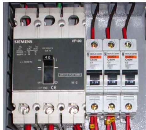
Fig. 44 Totalizador y Fusibles
