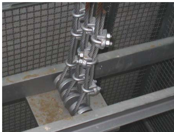
Figura 3. Extremos de los cables.
