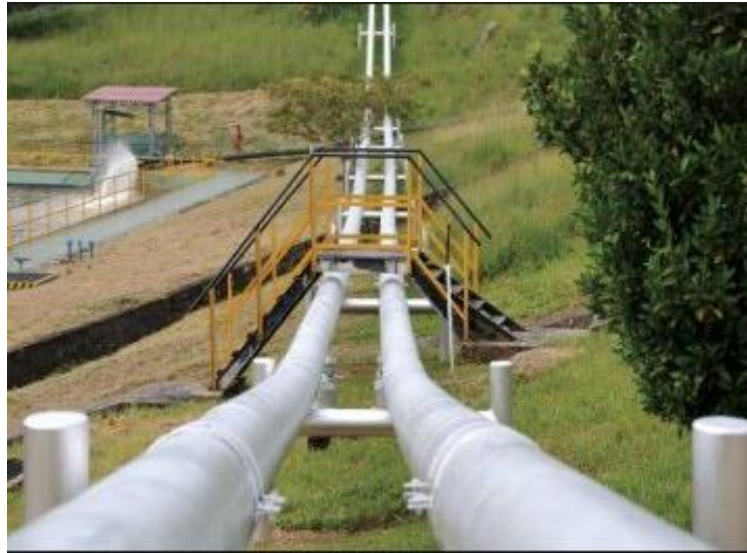
Figura 1. Tubería de línea
