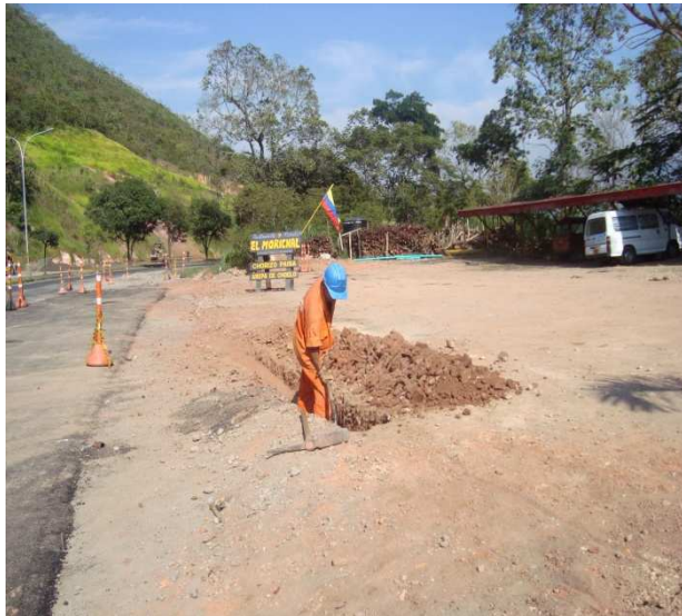
Ilustración 9. Canalización en Espacio Pública, Tramo PQP - Piedecuesta.
