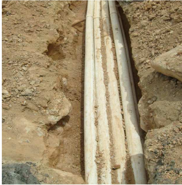
Ilustración 12. Ductos existentes, Tramo 3 (Puente Cañaverl – PQP).
