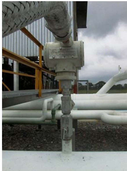
Figura 7. Transmisor de Presión (PT 01)
