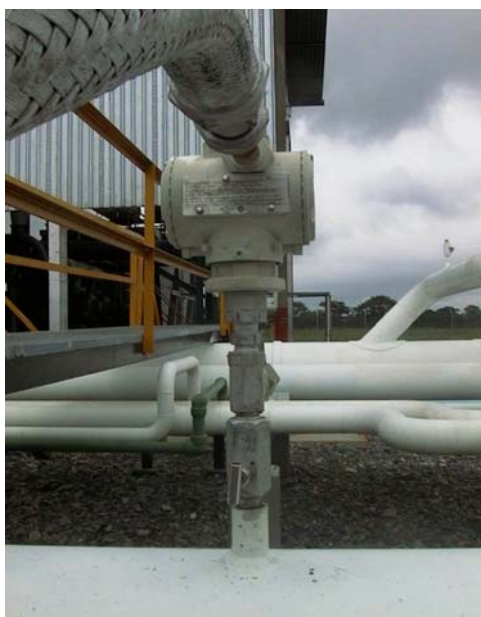
Figura 15. Transmisor de Presión (PT 03)
