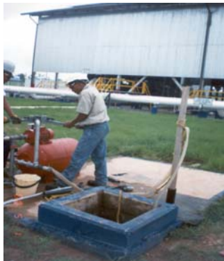
Imagen tomada en las estaciones compresoras Uniwhale de Colombia E.U.
