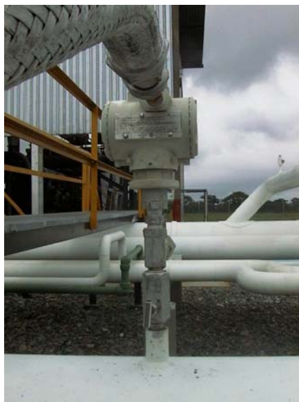
Figura 11. Transmisor de Presión (PT 02)
