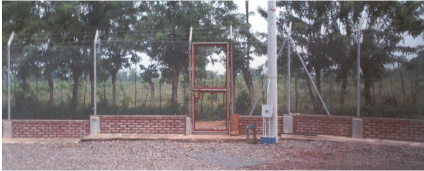
Imagen tomada en las estaciones compresoras Uniwhale de Colombia E.U.
