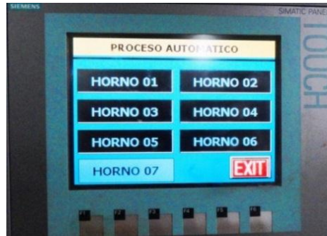
Figura 9. Visualización Pantalla Control del proceso de tratamiento térmico Software Simatic Win CC Flexible.
