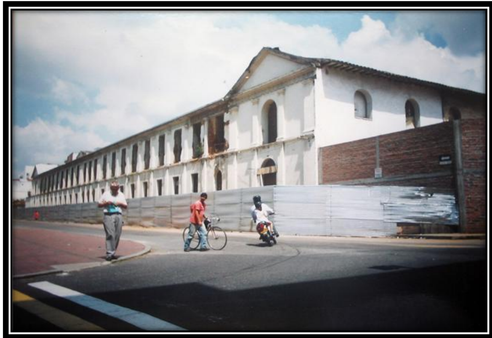
Figura 42. El edificio deteriorado década 1990. 288
