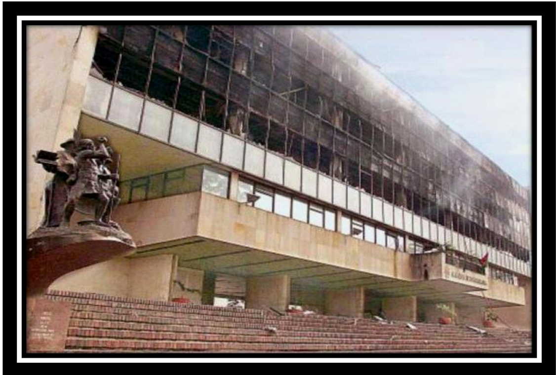
Figura 34. Imagen del edificio de la alcaldía luego del incendio sufrido en 2002. 212
