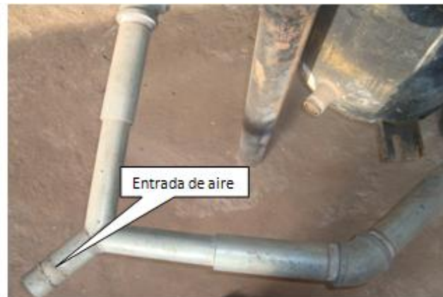
Figura 8 Fotografías del Circuito de aire
