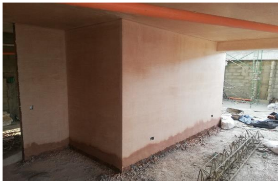
Figura 7. Revisión de friso en muro de mampostería
