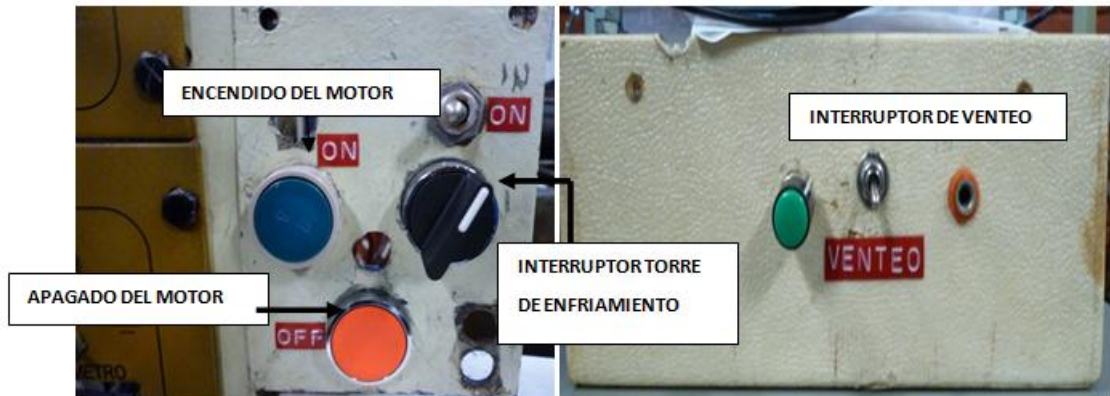
Figura 73. Interruptores de la sección hidráulica.
