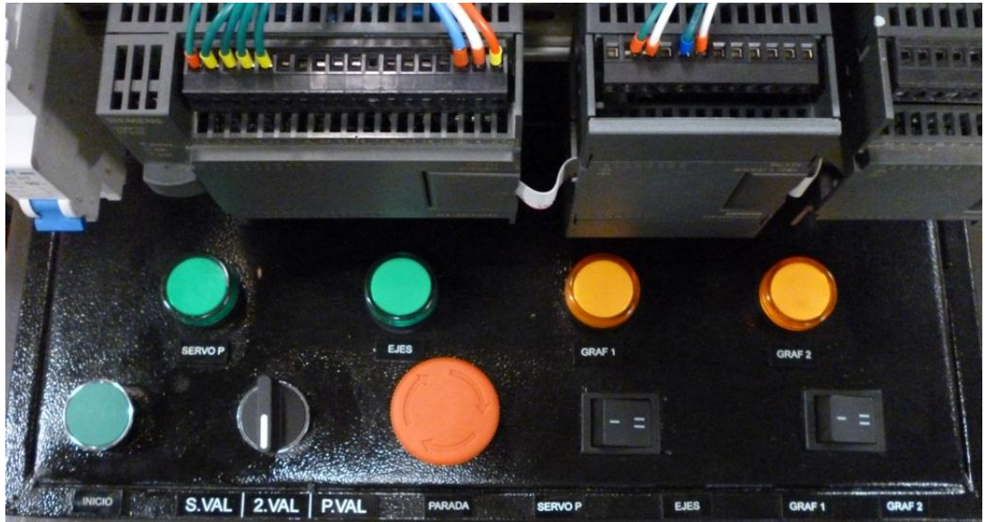
Figura 96. Panel de control del PLC.
