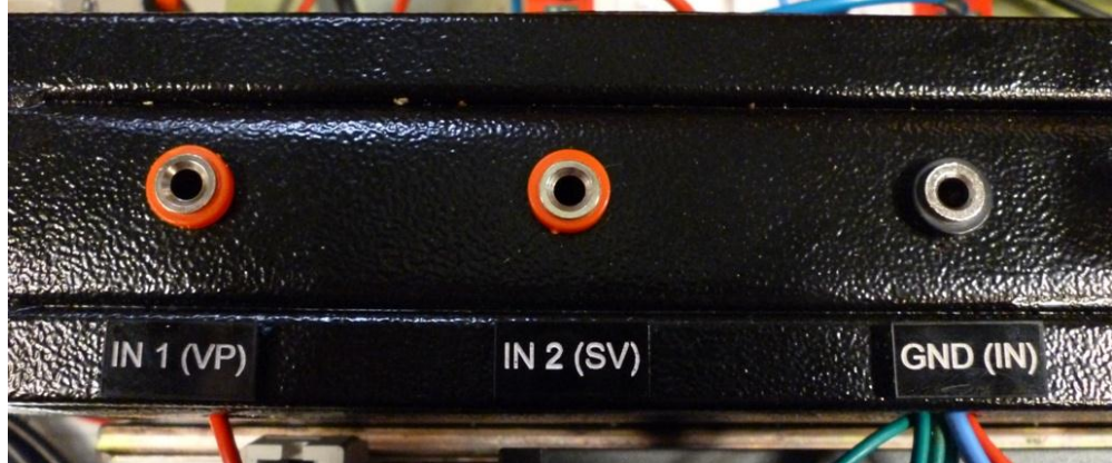
Figura 65. Entradas del PLC.
