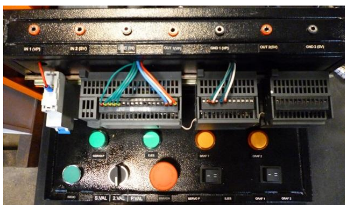
Figura61. Panel de control del PLC.
