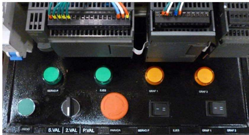
Figura 78. Panel de control del PLC.
