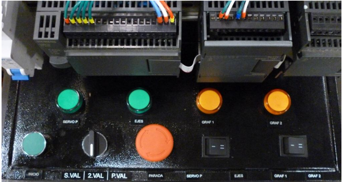
Figura 88. Panel de control del PLC.
