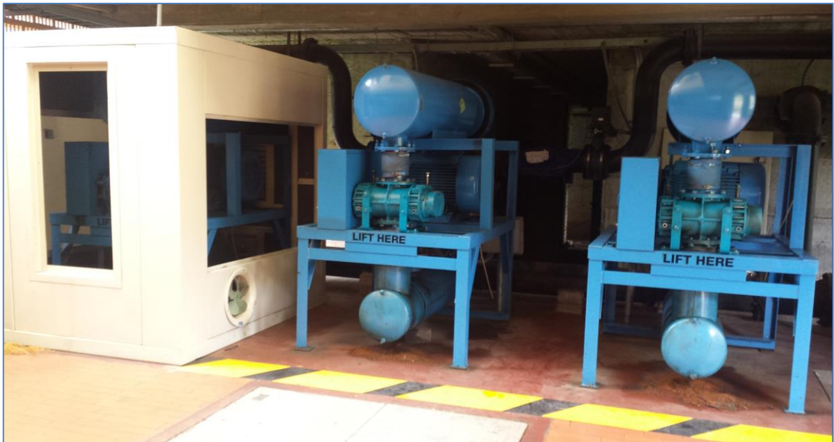
Fotografía 4. Compresores para el aireado en los reactores SBR.
