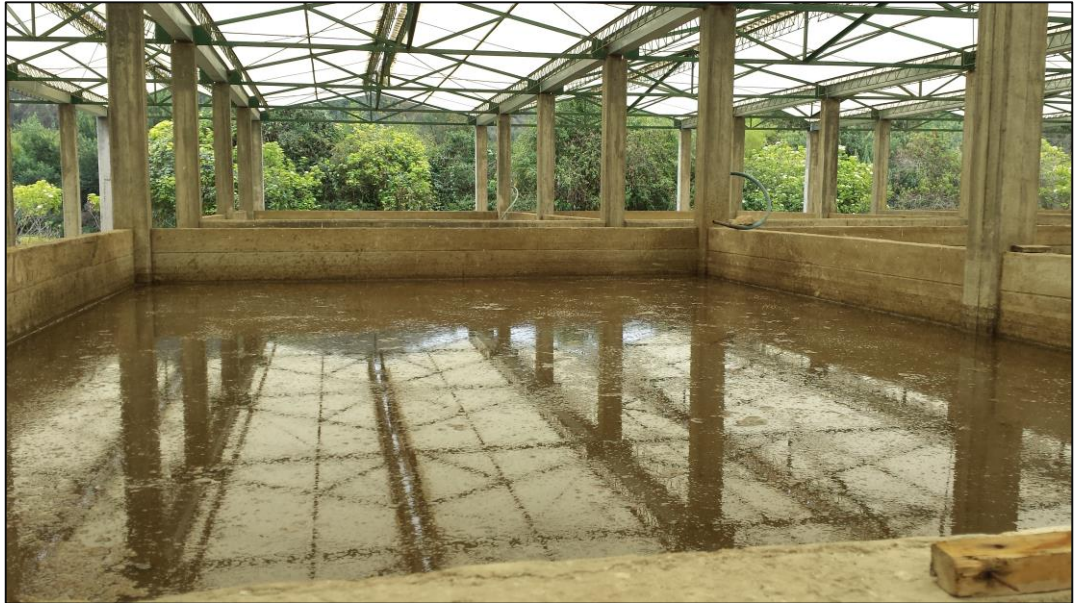
Fotografía 10. Lechos de secado de lodos.
