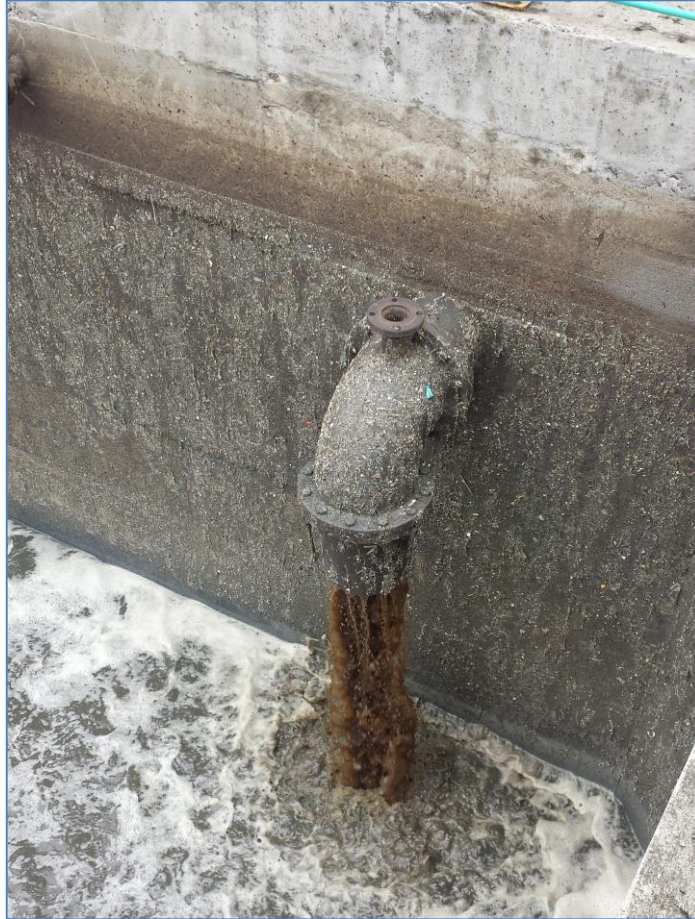
Fotografía 6. Entrada de aguas residuales al PTAR.
