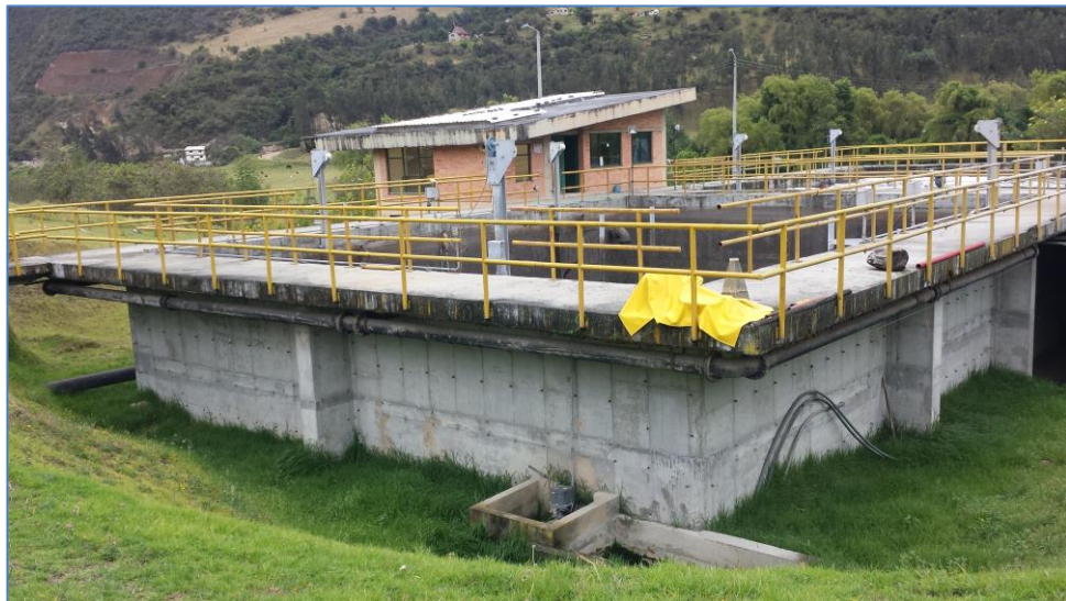
Fotografía 1. Planta de Tratamiento de Aguas Residuales de La Calera.
