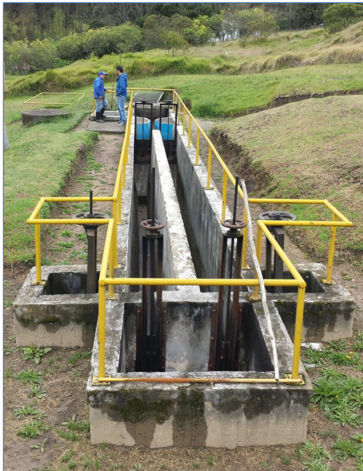
Fotografía 2. Etapa de pretratamiento de la PTAR.
