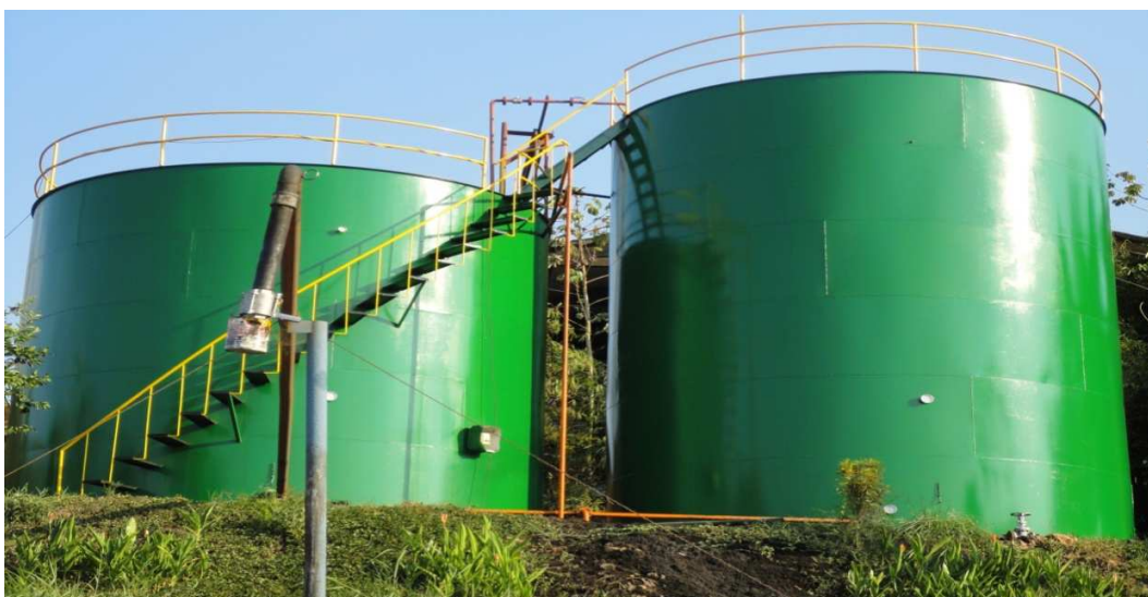
Figura 19. Tanques de Almacenamiento.
