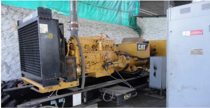
Figura 23. Planta Generadora de Electricidad.
