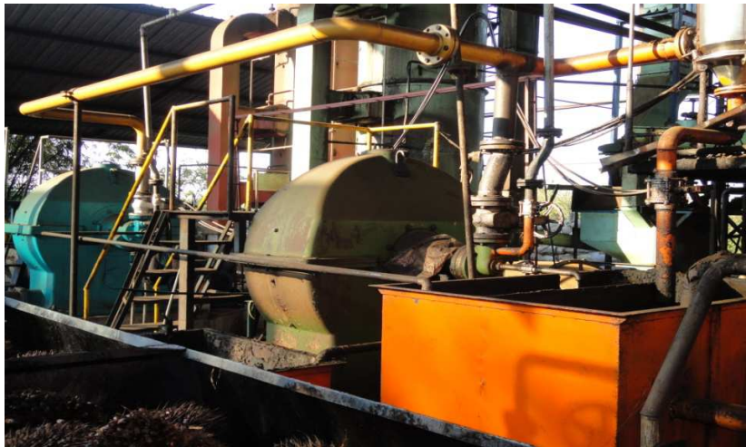
Figura 20. Bombas Centrífugas de Lodos.
