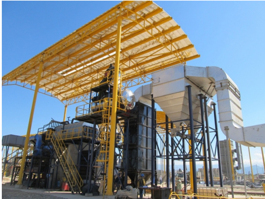
Figura 3. Zona de Calderas Extractora de Aceite de Palma La Gloria.
