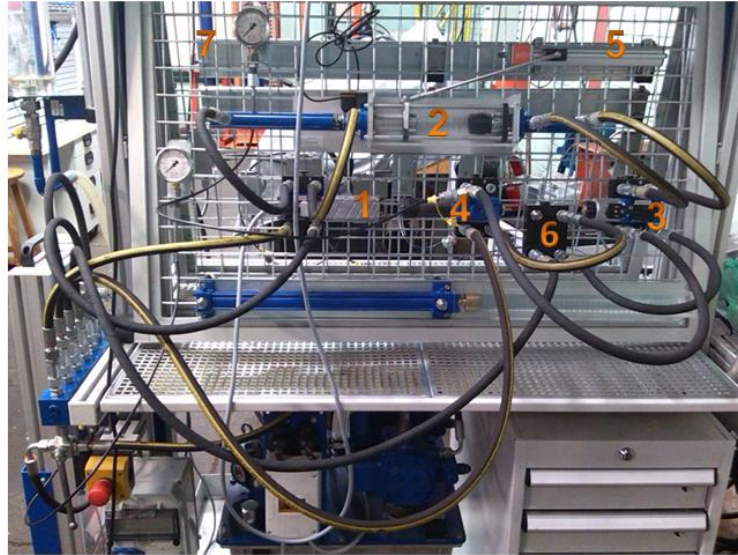
Figura 26. Montaje hidráulico servo de posición.
