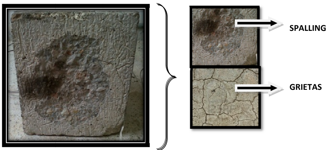
Figura 23. Probeta de concreto reforzado y sin adición de fibra expuesta a 1200°C
