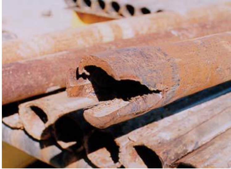
Figura 13. Fallas en las conexiones o juntas
