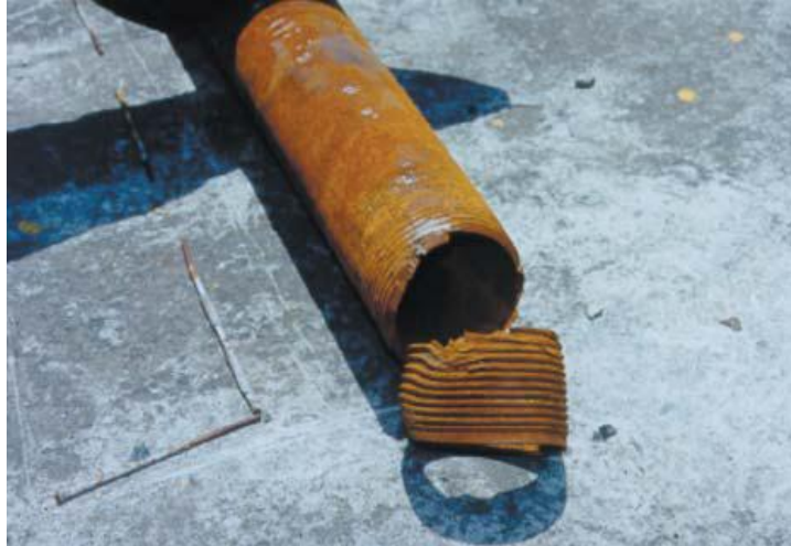
Figura 14. Fallas en juntas y cajas de tuberías de revestimiento
