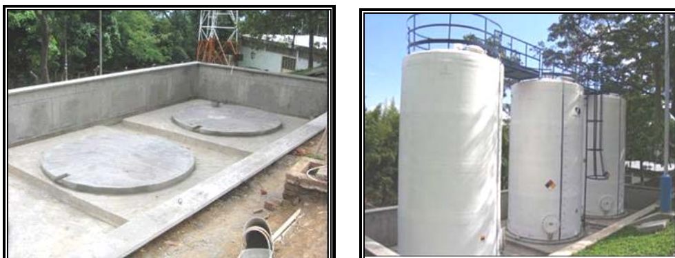
Figura 2. Sistema de dosificación de sulfato de aluminio líquido
