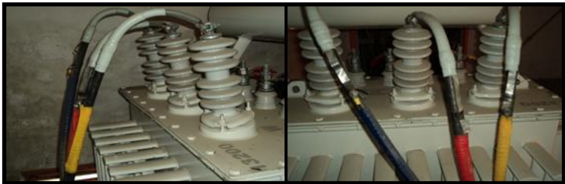
Figura 11: Conductores en bornes de entrada del transformador
