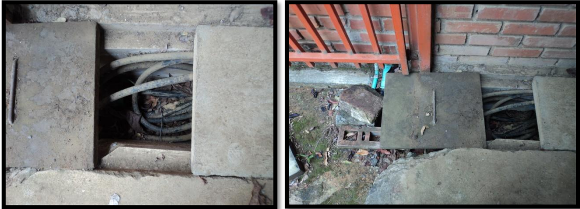
Figura 6: Acometida alimentación del edificio
