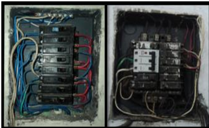
Figura 33: Muestra de tableros con inadecuada disposición de cableado.
