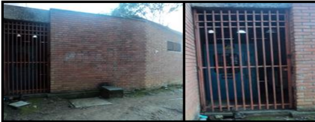
Figura 32: Falta de señalización en la subestación eléctrica
