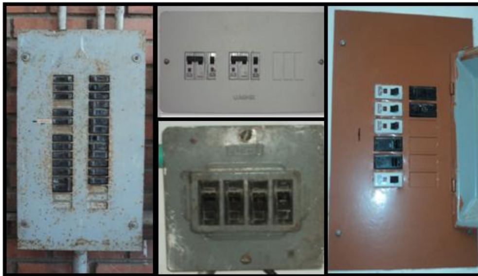
Figura 31: Algunos tableros que muestran la falta de señalización
