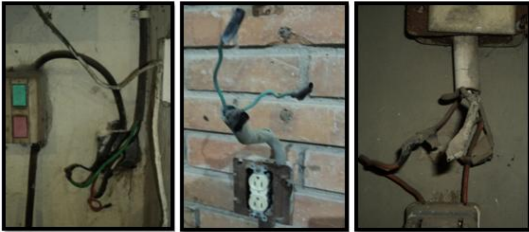
Figura 35: Algunos cables y empalmes expuestos
