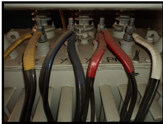
Figura 10: Conductores en bornes de salida del transformador
