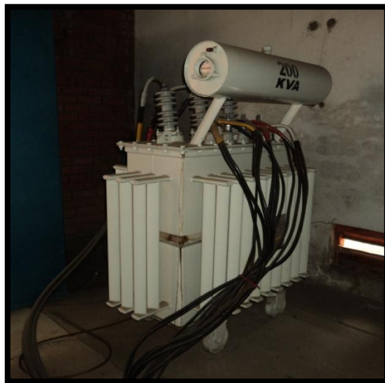
Figura 9: Transformador de potencia
