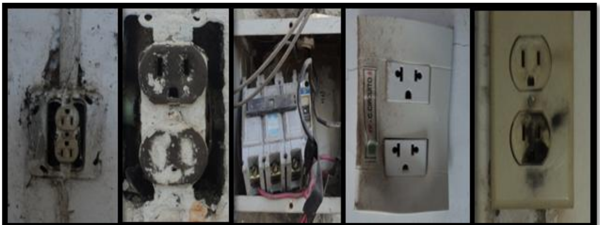
Figura 36: Aparatos en mal estado
