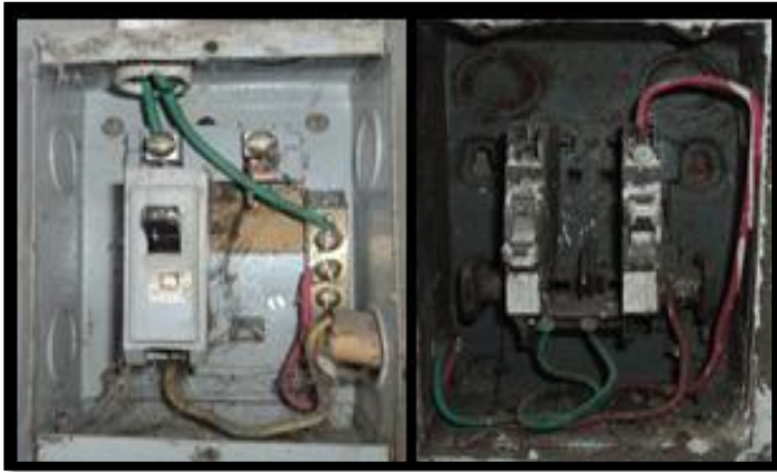
Figura 34: Muestra de falta de limpieza
