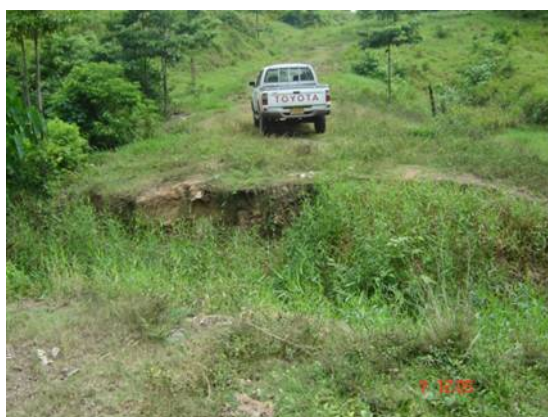
Figure 4–4: Hundimiento de la carretera en las inmediaciones de la Subestación 71
