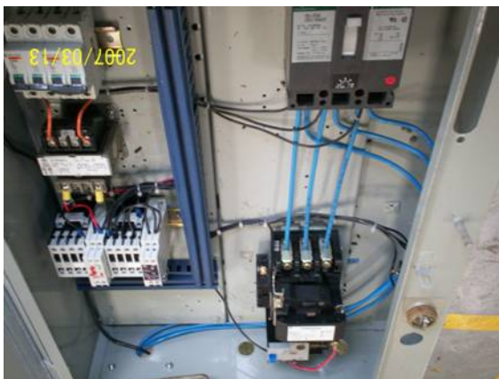
Figure 5-11: Parte interior de la Caja de Control.
