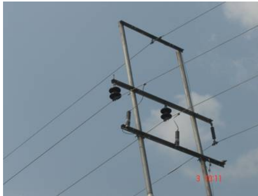
Figure 5-13: Inconsistencias en los equipos de protección. (DPS)
