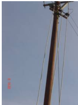
Figure 5–8: Acometida eléctrica del pozo
