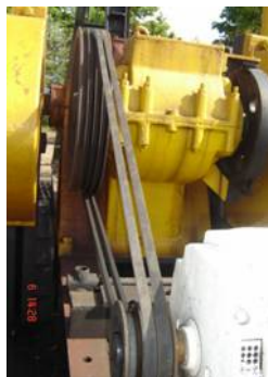
Figure 5–7: Transmisión de la unidad de bombeo Colorado 38
