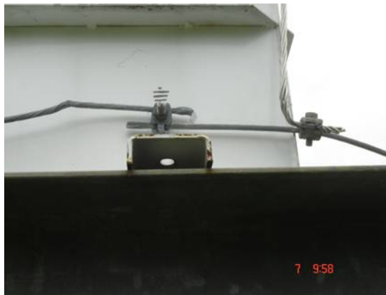
Figure 4–14: Conexiones de PaT en un Transformador
