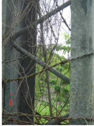
Figure 4–13: Cable de PaT en el bajante de una Subestación.
