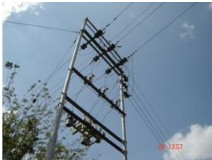
Figure 4-17: Banco de Condensadores existente en el Campo-Escuela Colorado
