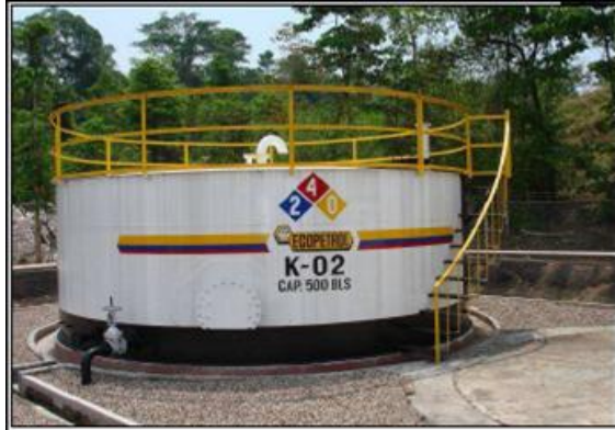
Figure 4-1: Tanque recolector con capacidad de almacenar 500 BPD
