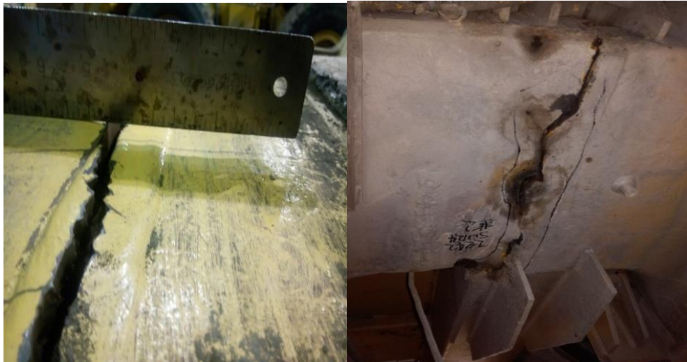
Figura 11. Evidencias Fotográficas de Grietas Chasis 2
