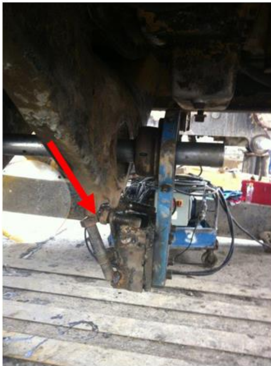
Figura 24. Imagen de Problemas Encontrados 1
