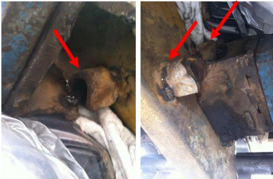
Figura 26. Imagen de Problemas Encontrados 3
