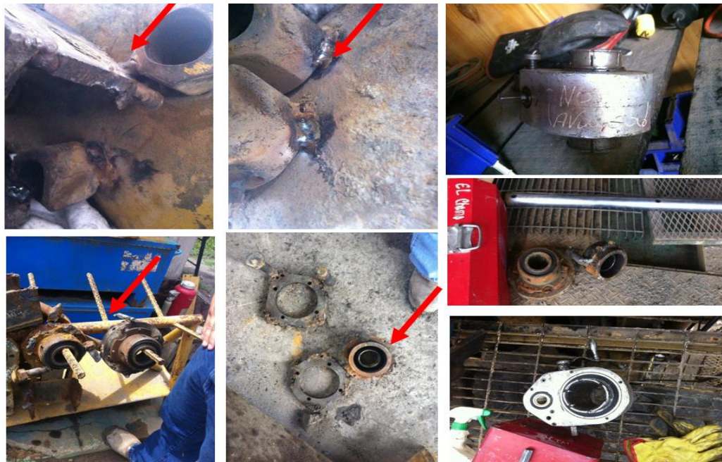
Figura 28. Imagen de Problemas Encontrados 5
