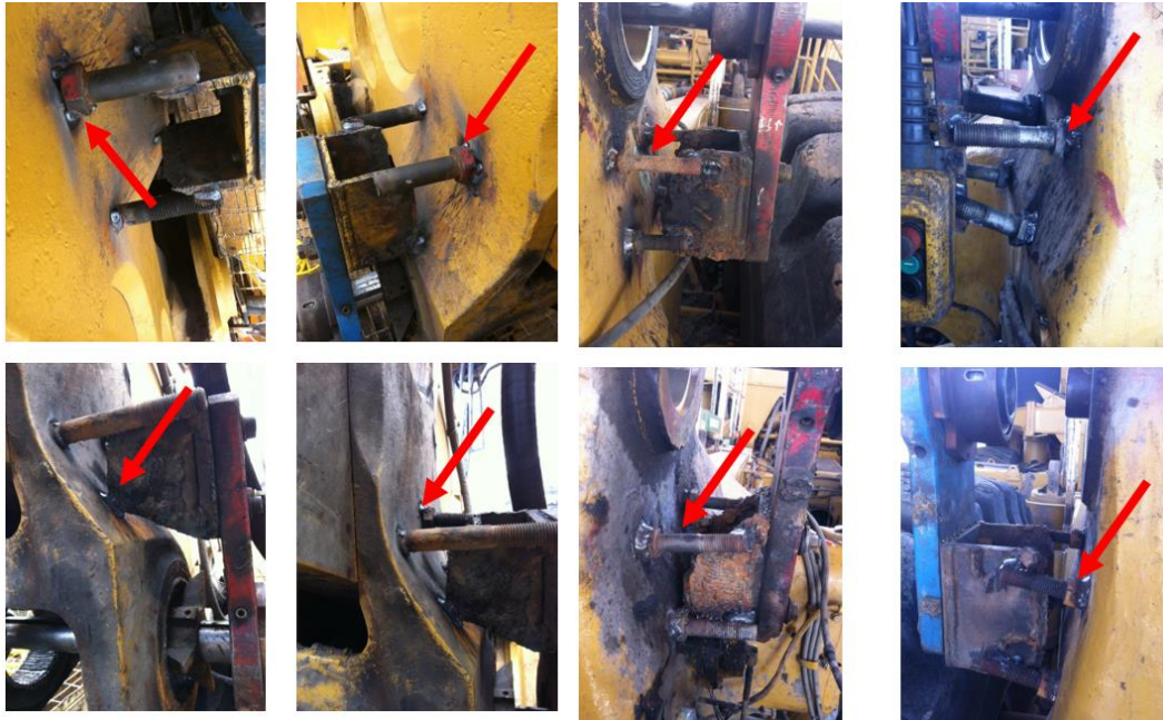
Figura 27. Imagen de Problemas Encontrados 4
